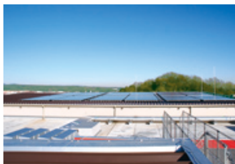
滝山工場屋上の太陽光発電パネル
