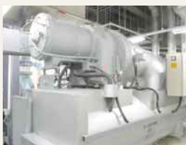
氷蓄熱システム冷凍機
